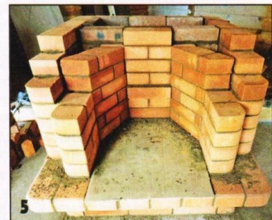
В топке камина (на 9-м ряду кладки) кирпич фронтальной стенки немного выдвинут. Этот выступ пригодится при жарке шашлыка.
